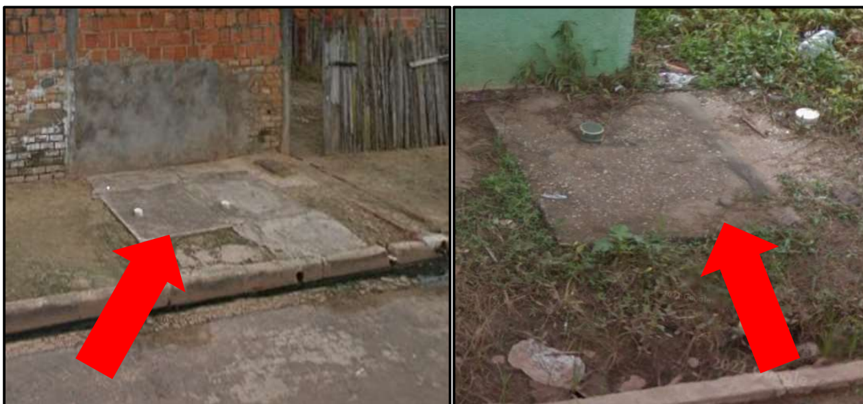
Figura 21. Sistema individual de tratamento de efluente sanitário utilizado pela população de Davinópolis
