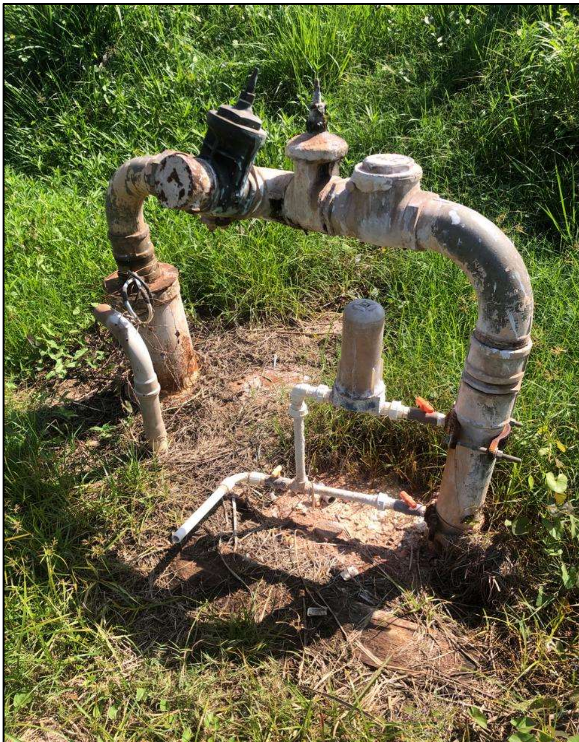
Figura 18. Bomba de captação de água do município Fonte. Autor,2021
