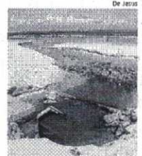
Arela cedeu e expôs esgoto
