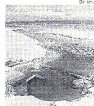
Areia cedeu e expôs esgoto
